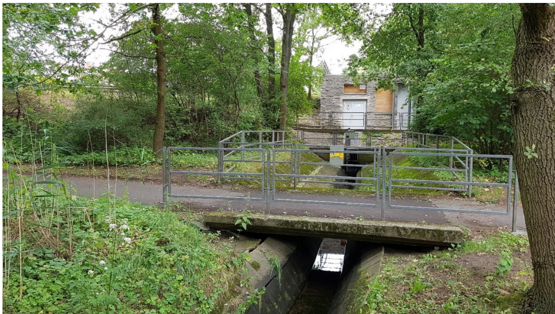
Abbildung 3-7: Pumpstation mit anschließendem Pumpwerkgraben
