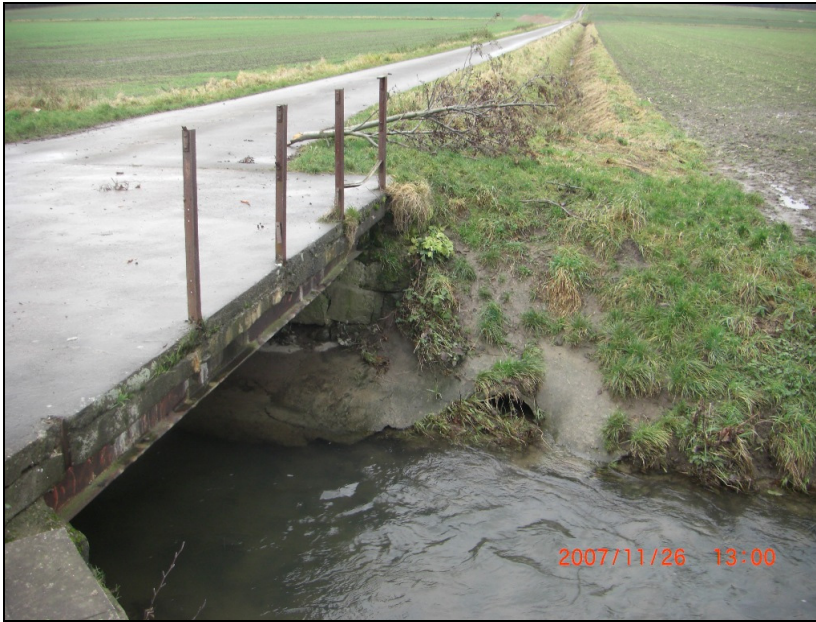
Abb. 32: Einmündung Wegeseitengraben in Wabe alt
