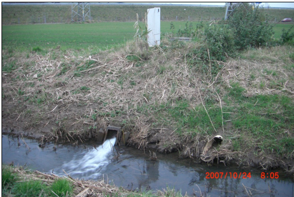
Abb. 11: Schöpfwerk und Dränauslauf mit Vorflut Reitlingsgraben
