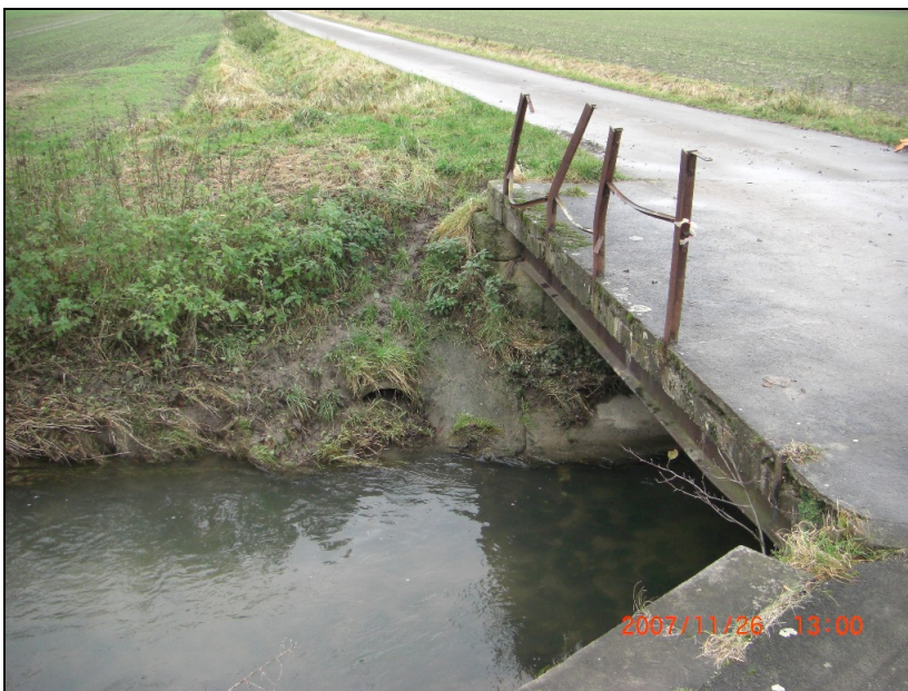
Abb. 31: Einmündung Wegeseitengraben in Wabe alt
